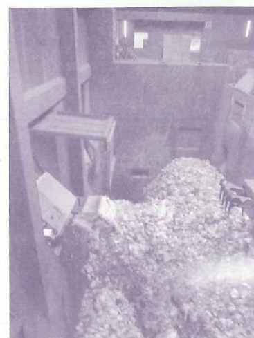
可燃ごみピット
